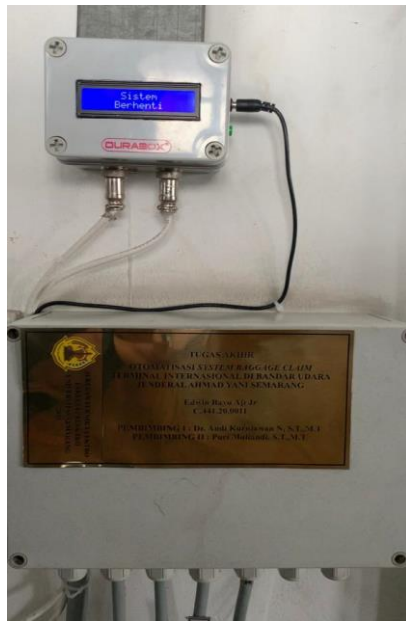
Gambar 13 Letak Pemasangan Box Panel
