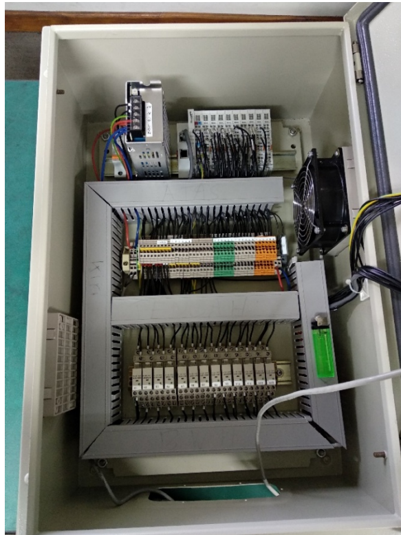
Gambar 11. Tampak Bagian Dalam Panel Kontrol [3]
